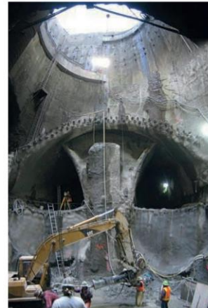
Fig. 4 Utilisation de puits profonds pour l'assèchement dans le cas de l'excavation d'un tunnel à Beacon Hill , Washington
